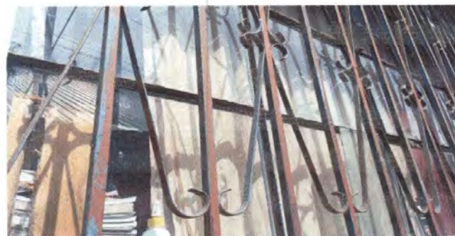
Foto 2: Sustrucción de balcones de metal en Módulo 1
