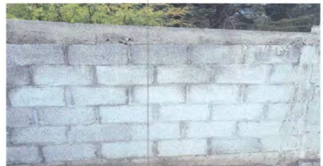
Foto 4: Cernido en muro en Área de Ingreso
